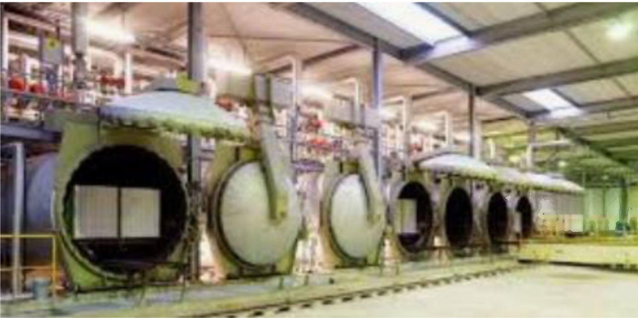
Autoclaven in de kalkzandsteenproductie (VNKP)
